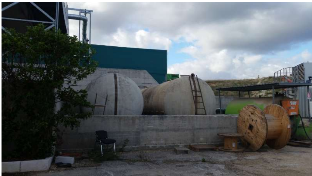
Cisterne di accumulo percolato
